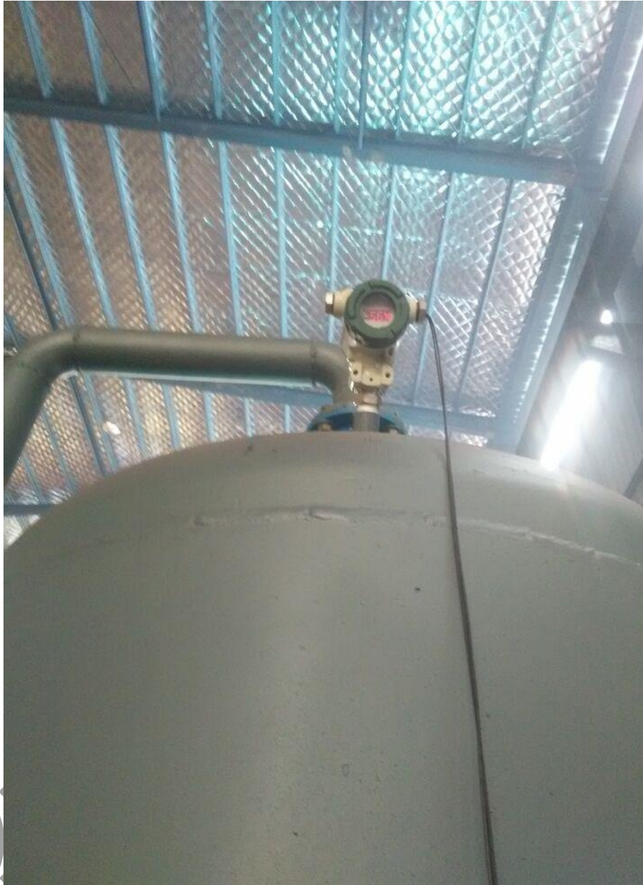
真空缓冲罐和数显防爆压力表
